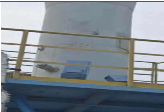
排气筒取样口
