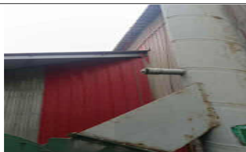
排气筒取样口
