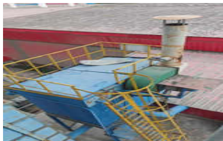
排气筒取样口
