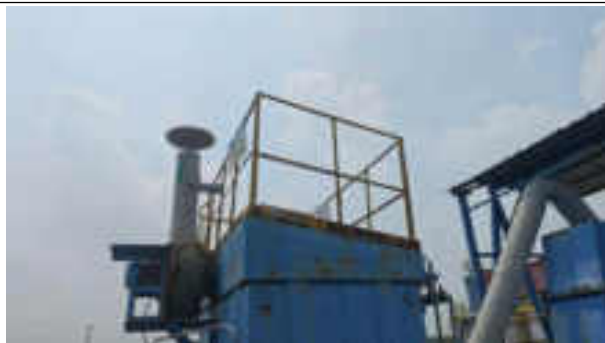
排气筒取样口
