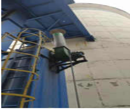
排气筒取样口
