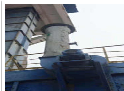
排气筒取样口
