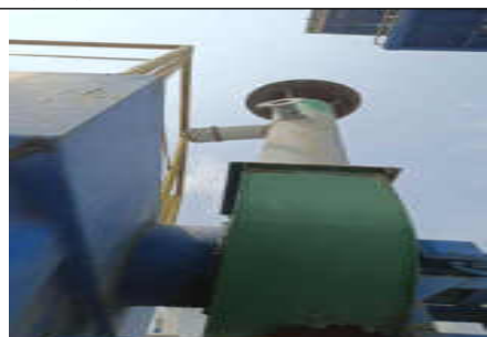
排气筒取样口
