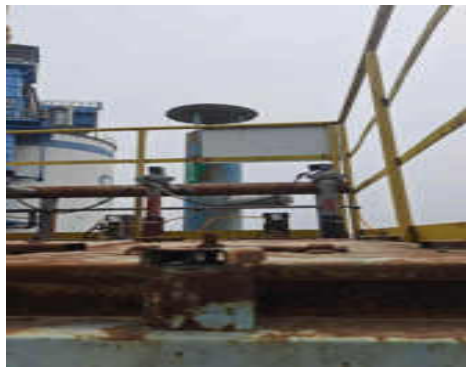
排气筒取样口
