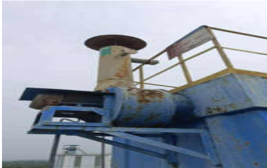
排气筒取样口
