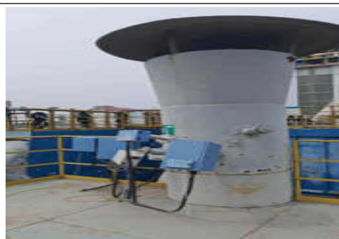
排气筒取样口
