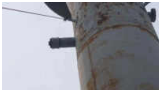
排气筒取样口
