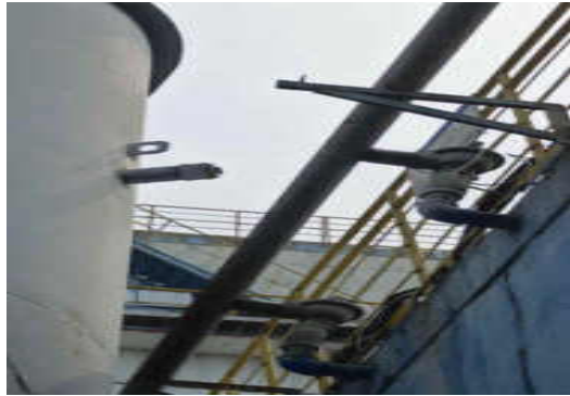
排气筒取样口
