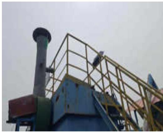
排气筒取样口
