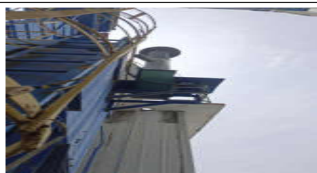
排气筒取样口
