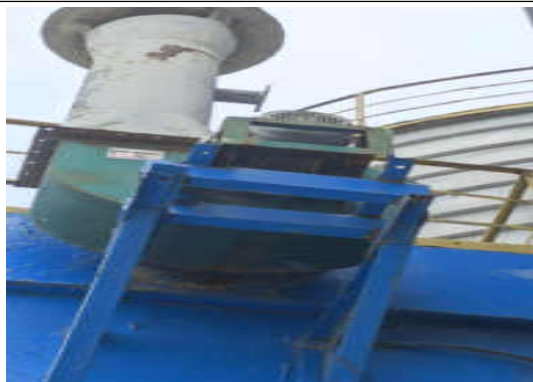
排气筒取样口
