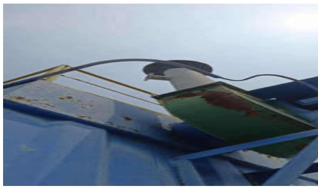
排气筒取样口
