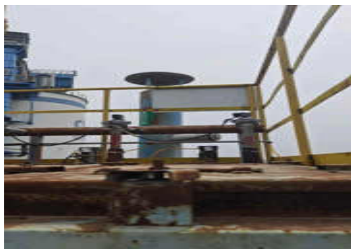
排气筒取样口
