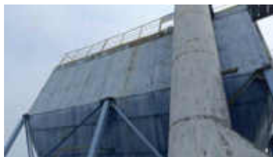
排气筒取样口
